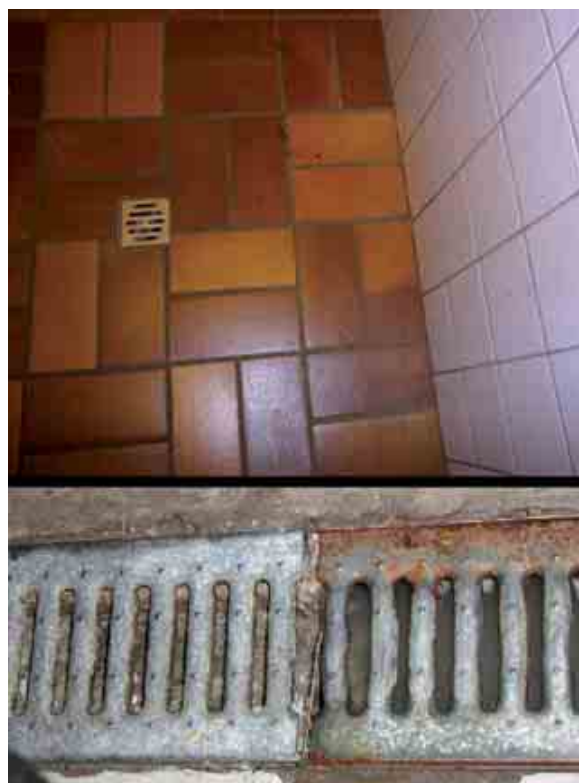
Ein Abfluss vereinfacht die Reinigung, verzinkte Abdeckungen oxidieren aber!
