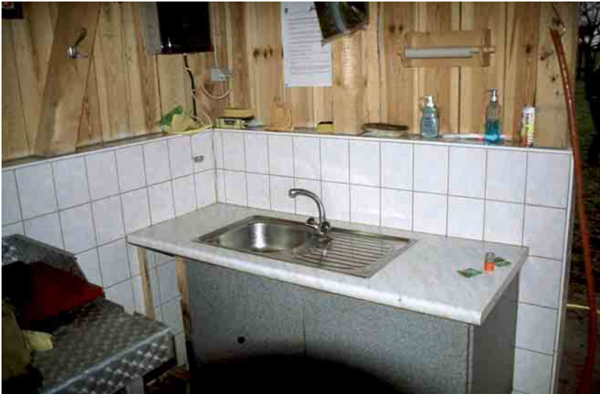
Notwendige Verbesserung: Das Holz (o.) braucht einen abwaschbaren Anstrich.
