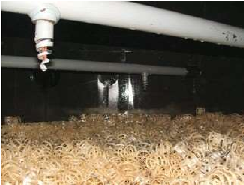
Innenansicht einer „sauren Wäsche“ der RETERRA-Freiburg
