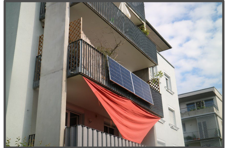
Balkon-PV-Anlage in Freiburg-Rieselfeld
